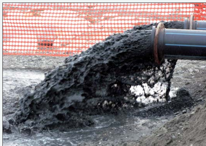
Figura 8 - Lo scarico della pompa Toyo a 900 m senza booster
